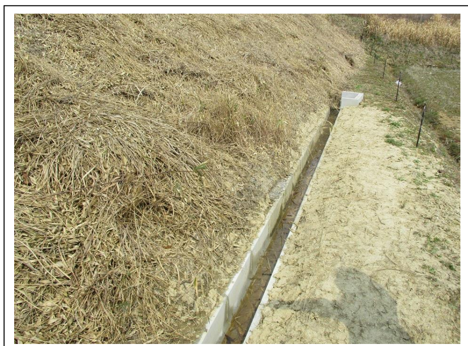
平成30年度災害の補修箇所
