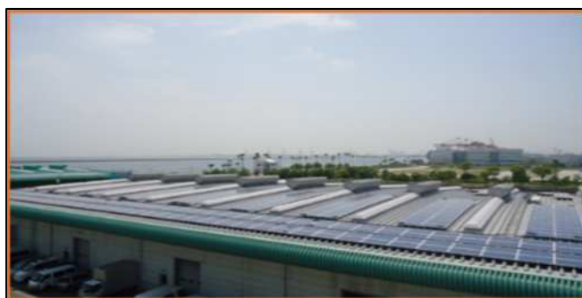
図 19 臨海部の屋根上太陽光発電設備
